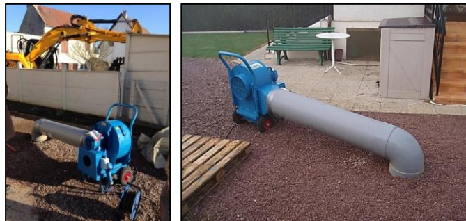
Illustration 12 : Ventilation mécanique sur le forage A (D33).
