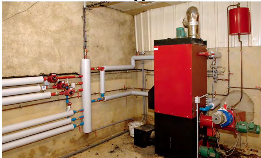
Chaudière utilisant du bois issu de l'élagage des haies
