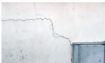
Effets d'un tassement différentiel sur une habitation
