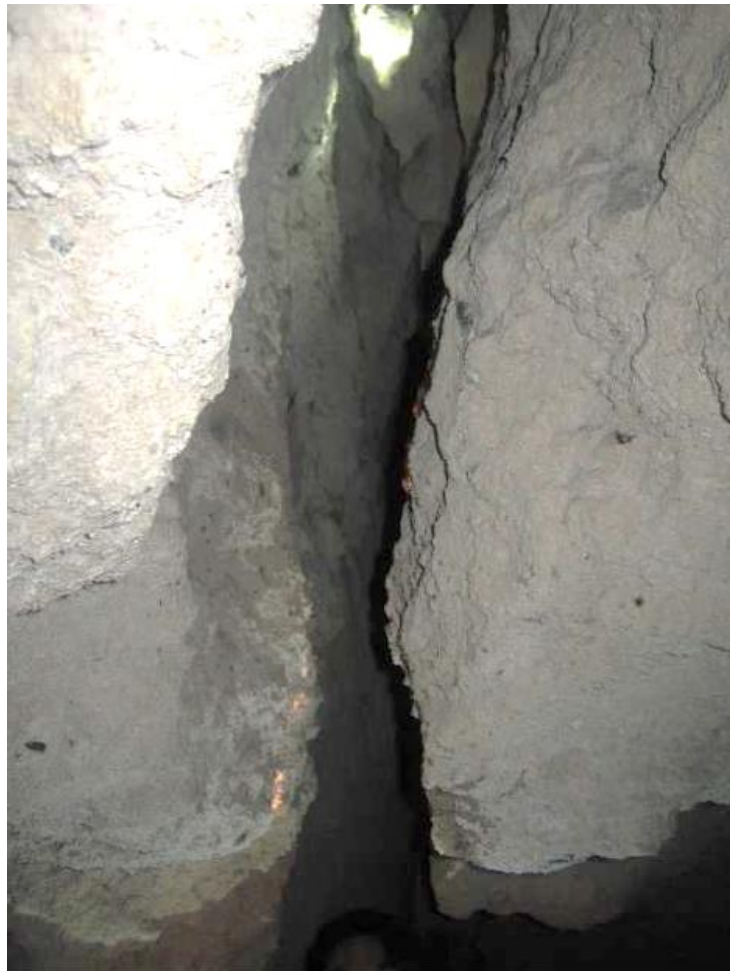
Illustration 74 : Exemple d'endo-karst, fissure verticale dans la galerie capante du Moulin est, sources de Radicatel, exploitées par l'agglomération du Havre (SAFEGE, 2012)
