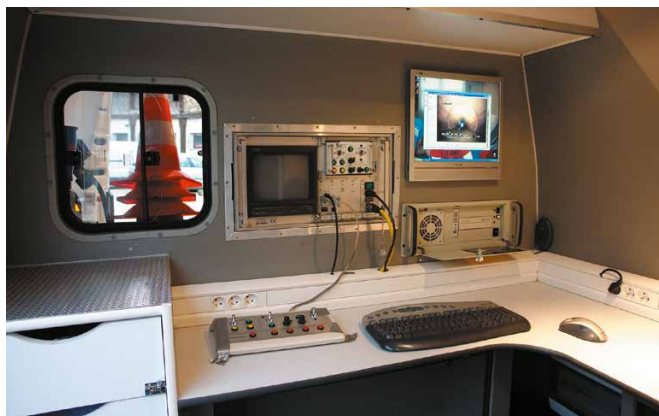
Poste de contrôle de caméras.
