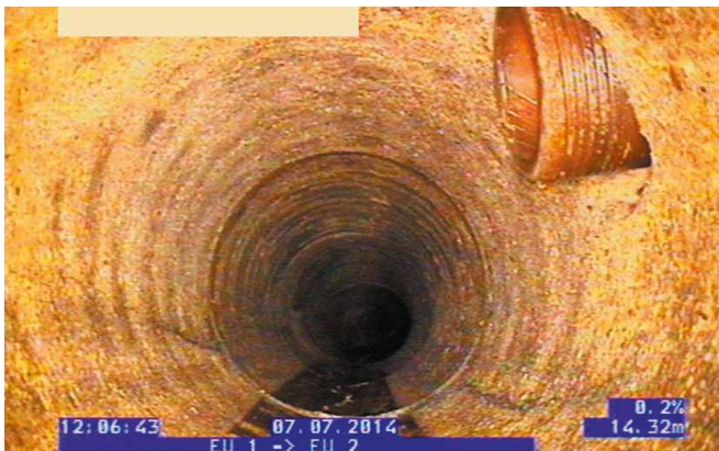
Raccordement mal effectué.
