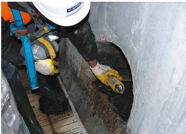
Raccordement dans un collecteur à banquettes.
