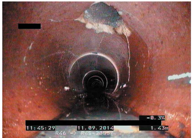
Fissures autour d'un embranchement.
