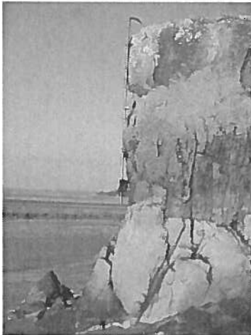
Tube menant au capteur (arraché) et perché (érosion depuis 10 ans)
