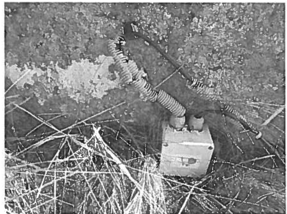
Connexion électrique détériorée
