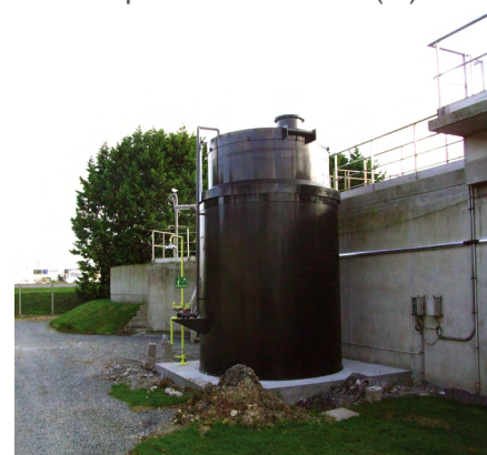
Station d'épuration de Ouistreham (14)
